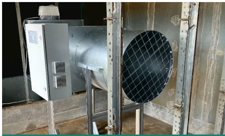
Chauffage électrique installé dans un bousquet.
