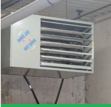
Fornaise au propane avec rejet des gaz de combustion à l'extérieur du bâtiment (Modine HDS).
