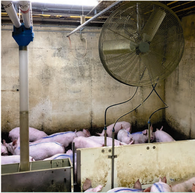
Ventilateur de recirculation
