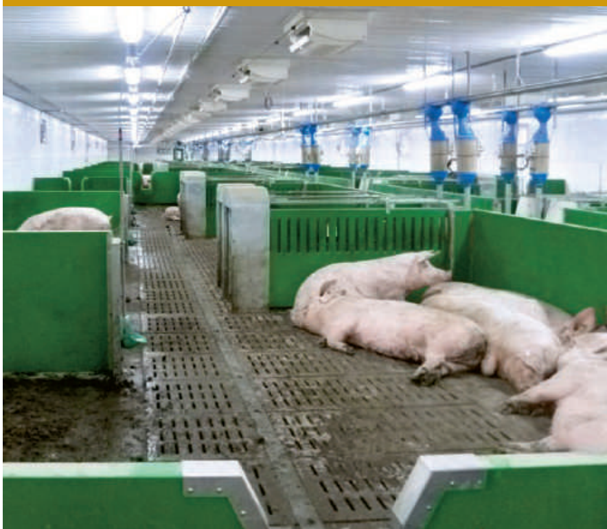
Photo 1 DAC autobloquants installés dans des fermes québécoises
