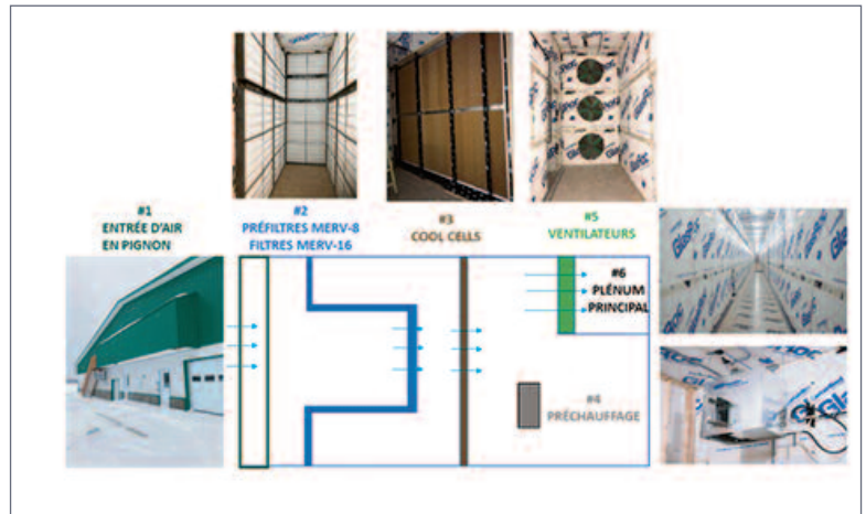
Figure 3 : Éléments du système de conditionnement de l'air d'une salle de traitement de l'air.
